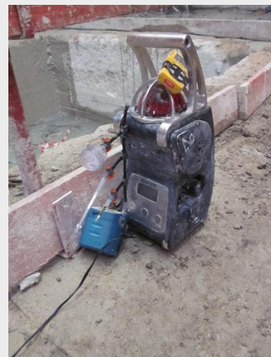
▲ Poste de mesure d'air ambiant
