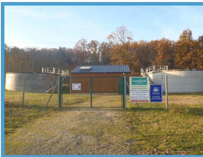
Vue du périmètre de protection immédiate et des installations du captage
